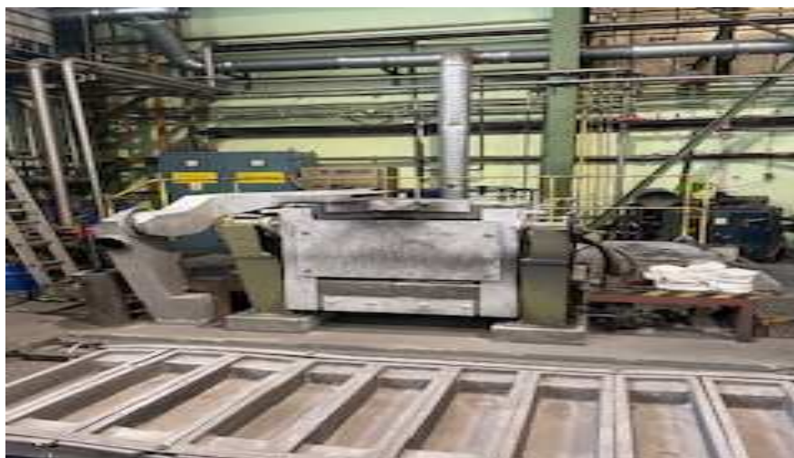
Brak odciągu zabezpieczającego przed emisją pyłów i gazów przy piecu tyglowym COLEMAN.
