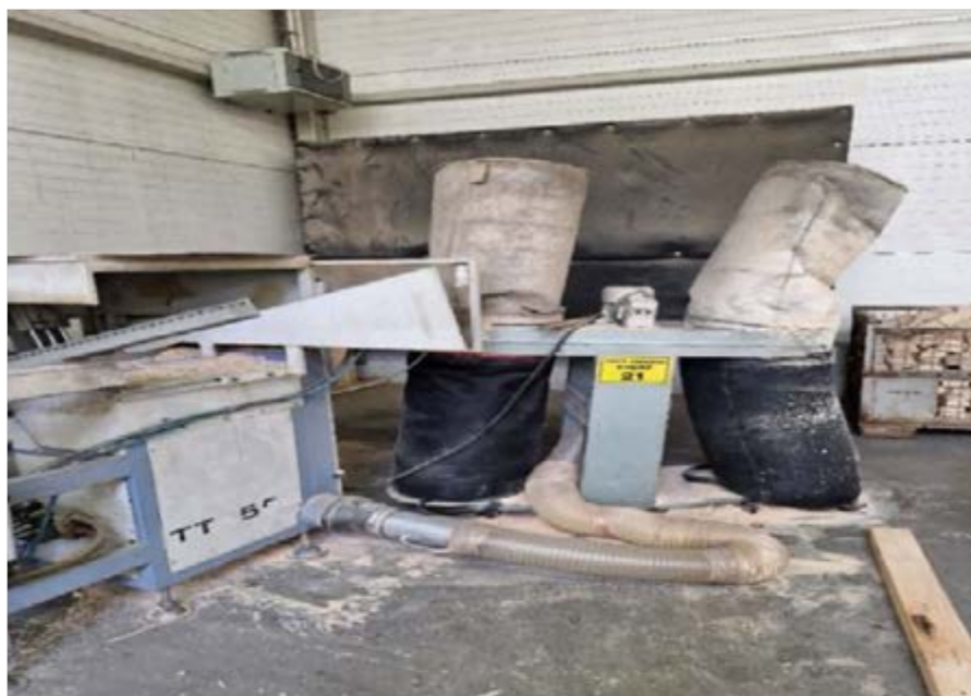
Stanowisko obsługi kostkarki wraz niesprawnym odciągami miejscowym z przepelnionymi workami.
