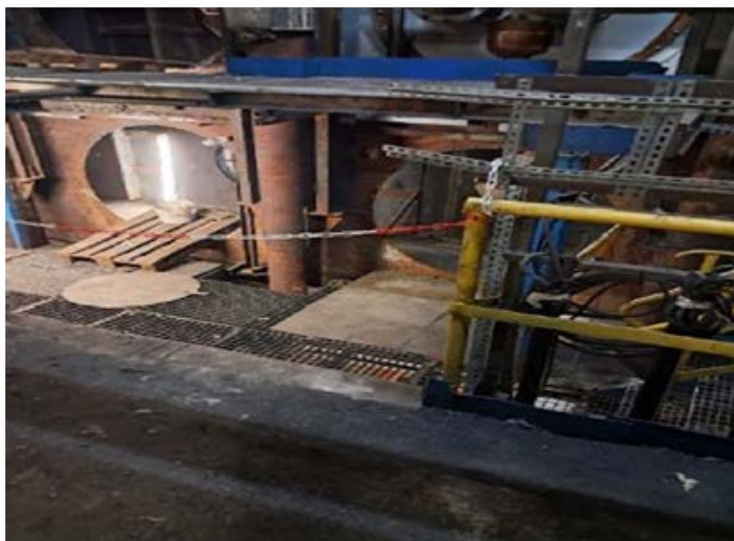
Niewłaściwie zabezpieczona przed możliwością upadku z wysokości - wyznaczona w poleceniu wykonania pracy - strefa pracy w rejonie prowadzonych prac remontowych (jako zabezpieczenie zastosowano wyłącznie łańcuch z tworzywa sztucznego).
