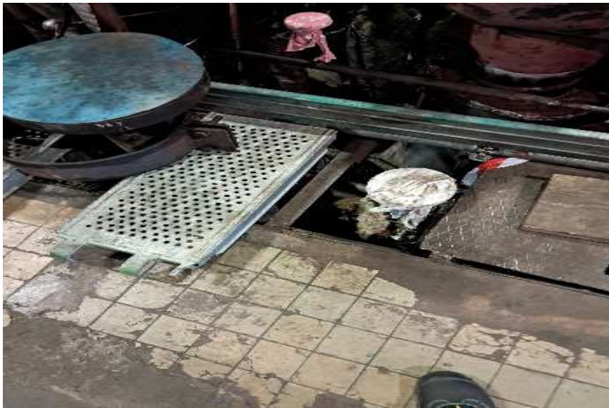
Niezabezpieczone miejsce, w którym występowała możliwość urazu kończyn dolnych w rejonie turbogeneratora, zlokalizowane wewnątrz – ustalonej w poleceniu wykonania pracy – strefy pracy.
