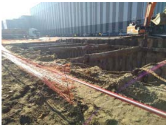
Niezabezpieczone krawędzie wykopu.
