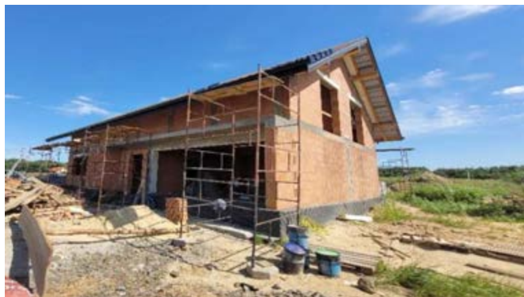
Nieprawidłowo zmontowane rusztowania typu „warszawskiego”.
