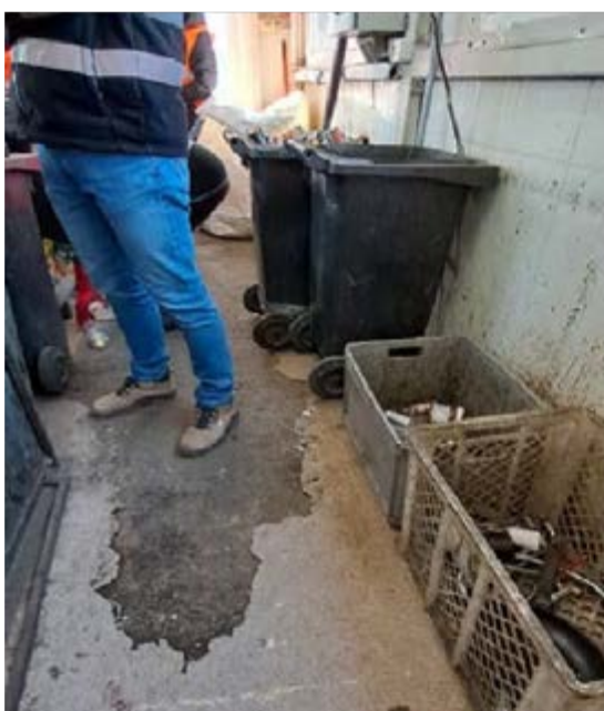
Podłoga w hali sortowni pokryta linoleum, miejscowo uszkodzonym, z wyrwanymi fragmentami, pod linoleum podłoga wykonana z materiału niezmywalnego
