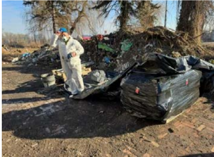
Pracownik stosujący uszkodzony, rozerwany kombinezon ochronny bez poprawnego założenia kaptura ochronnego na głowę
