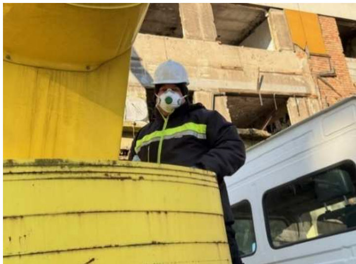
Operator podestu roboczego nie stosujący kombinezonu ochronnego oraz okularów ochronnych
