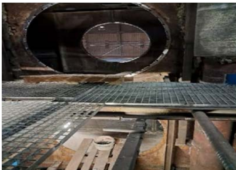
Niezabezpieczona przed możliwością upadku na niższy poziom przestrzeń powstała w związku z usunięciem krat WEMA - rejon miejsc montażu palników pyłowych w ścianie kotła.
