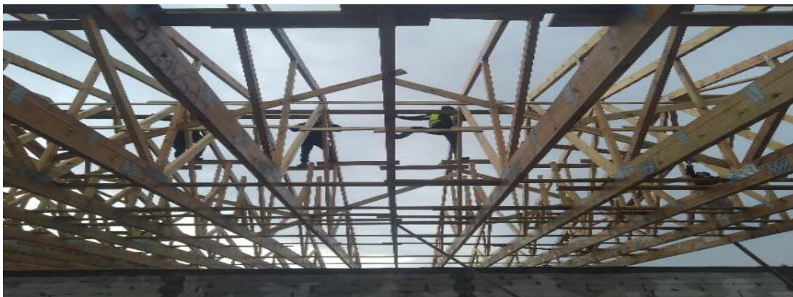
Montaż więźby dachowej pawilonu handlowego na wysokości kilku metrów. Pracownicy wykonujący prace na konstrukcji nie byli wyposażeni w środki ochrony indywidualnej zabezpieczające przed upadkiem z wysokości oraz hełmy ochronne.
