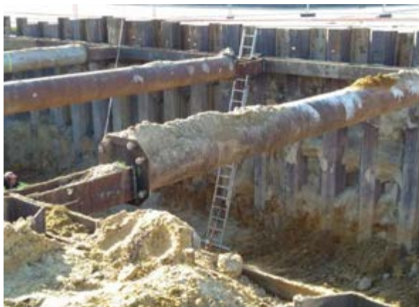
Nieprawidłowe zejście do wykopu.
