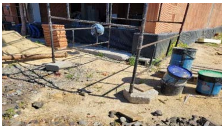
Miejsce upadku poszkodowanego z rusztowania
